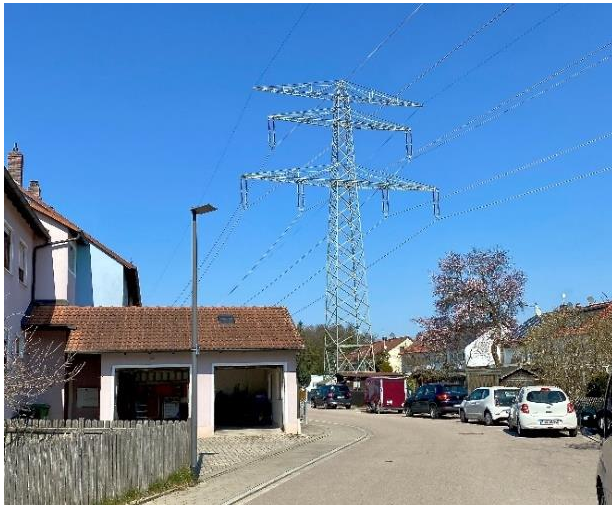
© Gerhard Raum. 220 kV-Bestandsleitung in Ezelsdorf/Burgthann.
